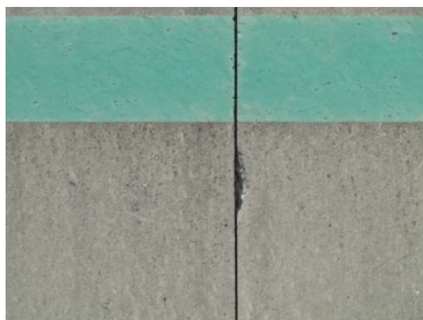
S3 중앙분리대 파손( A=0.1 \times 0.2=0.02m^2 )
