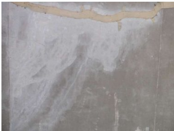
S4 바닥판 균열( C_w=0.2/L=1.0m )
