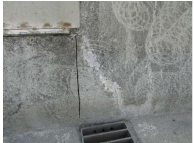
S4 방호벽 균열( C_w=0.2/L=0.5m )
