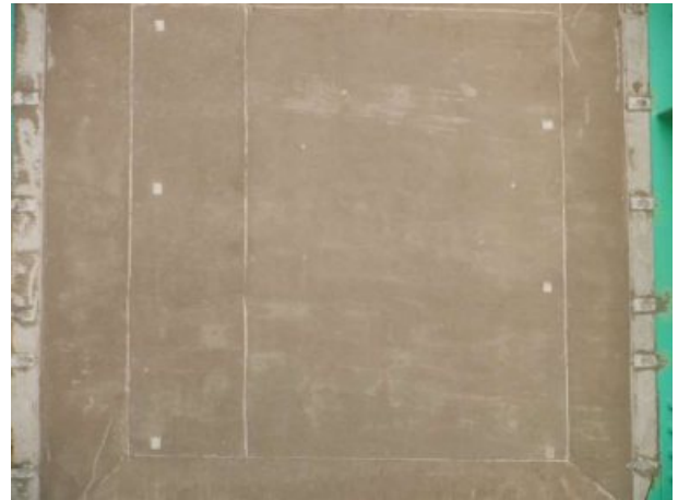
S3 바닥판 균열( C_w=0.2/L=2.0m )
