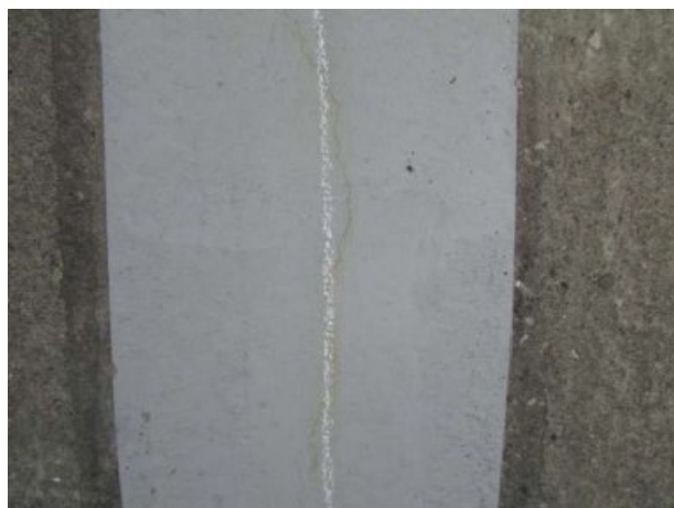
S3 방호벽 보수부 균열부백태( C_w=0.5/L=1.0m )
