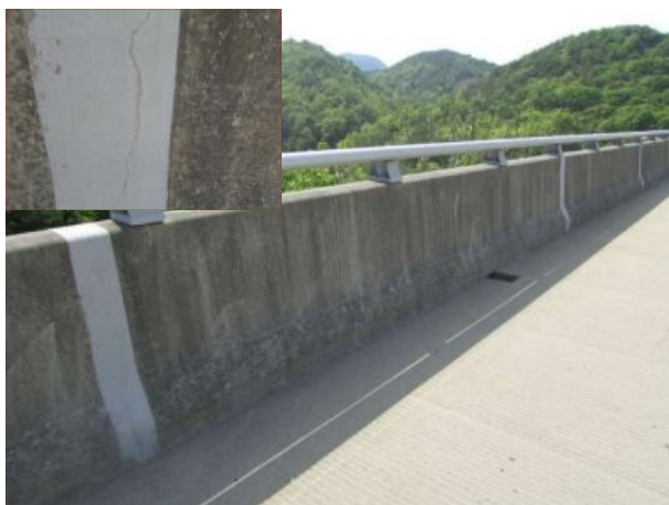
S1 방호벽 보수부재균열( C_w=0.2/L=1.2m )
