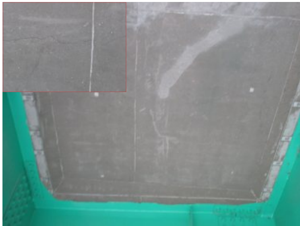
S3 바닥판 균열( C_w=0.3/L=1.6m )
