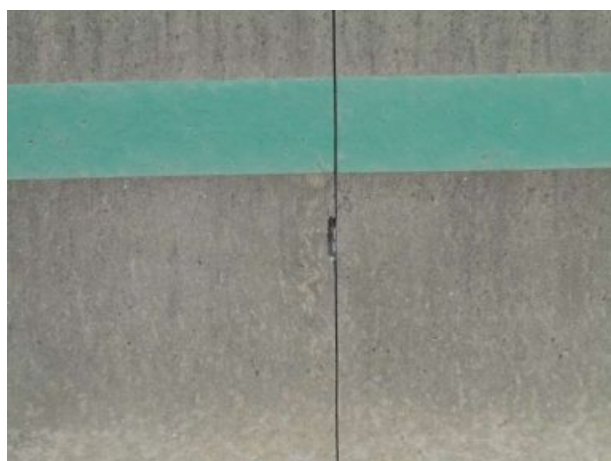
S2 중앙분리대 파손( A=0.1 \times 0.1=0.01m^2 )
