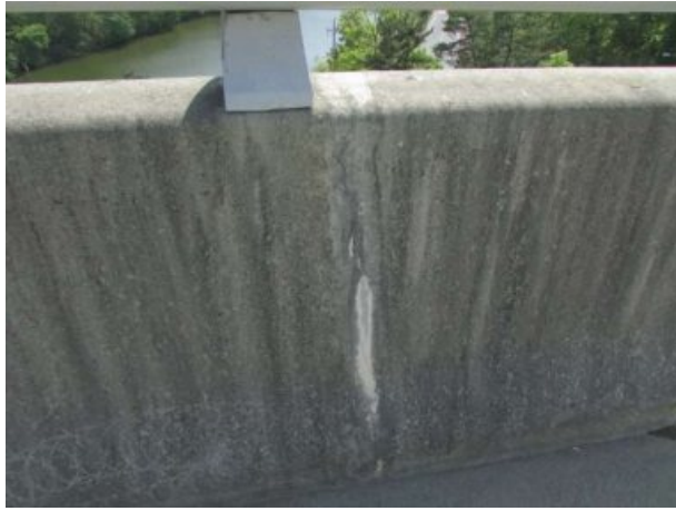
S3 방호벽 보수부재균열( C_w=0.2/L=1.0m )
