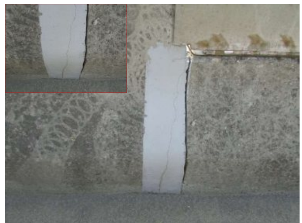
S1 방호벽 보수부재균열( C_w=0.2/L=0.6m )
