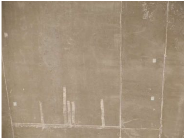
S3 바닥판 균열( C_w=0.2/L=1.2m )
