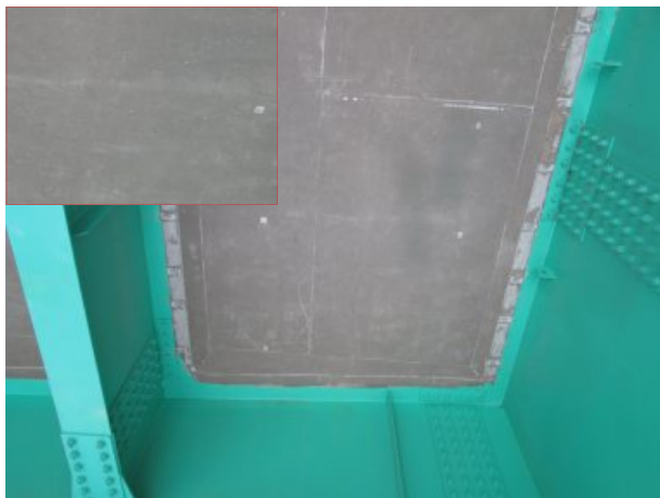
S3 바닥판 균열( C_w=0.2/L=1.6m )
