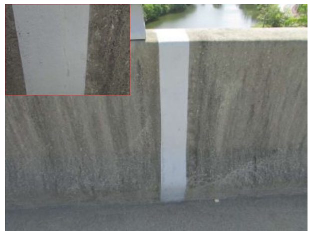
S2 방호벽 보수부재균열( C_w=0.2/L=1.1m )
