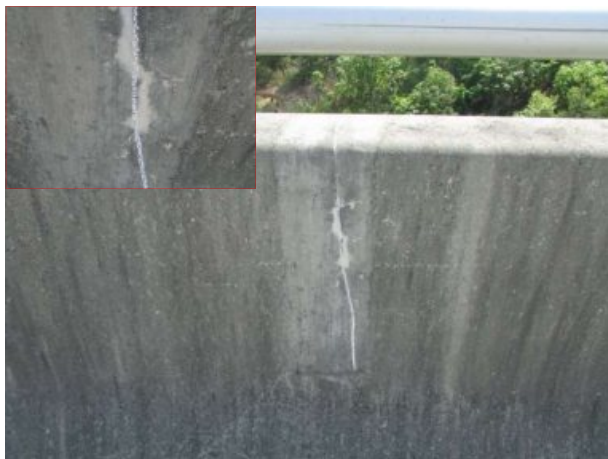
S4 방호벽 보수부재균열( C_w=0.2/L=1.0m )
