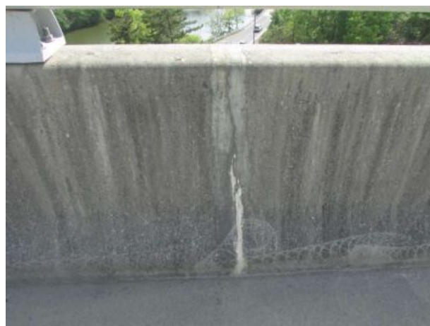
S3 방호벽 보수부 균열부백태( C_w=0.2/L=1.0m )
