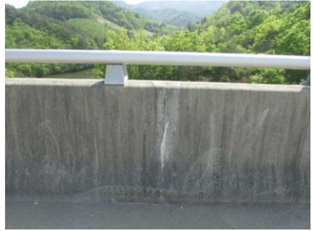
S4 방호벽 보수부재균열( C_w=0.2/L=1.0m )
