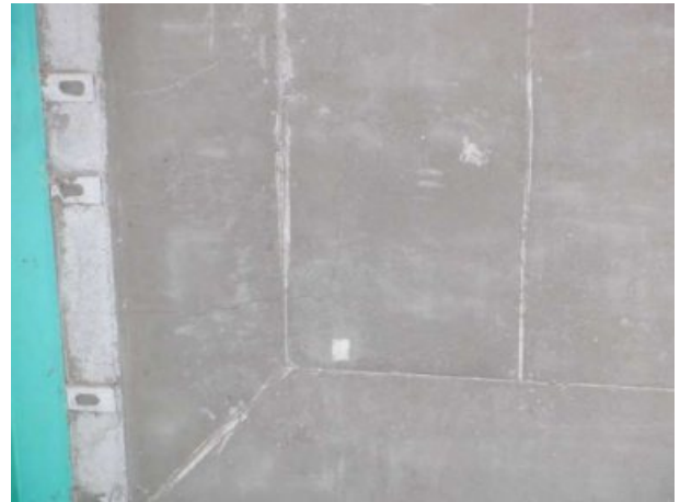
S4 바닥판 균열( C_w=0.2/L=1.0m )
