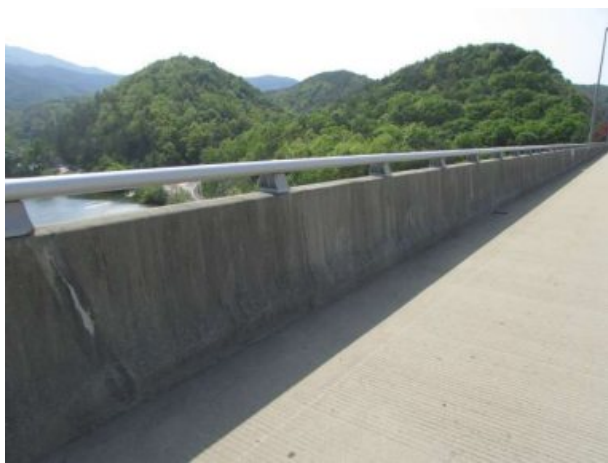
S2 방호벽 보수부재균열( C_w=0.2/L=1.2m )
