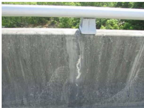
S4 방호벽 보수부 균열부백태( C_w=0.2/L=1.0m )
