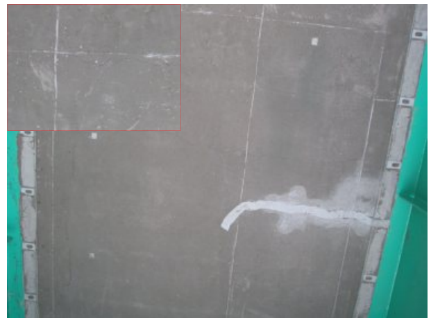
S3 바닥판 균열( C_w=0.2/L=1.6m )
