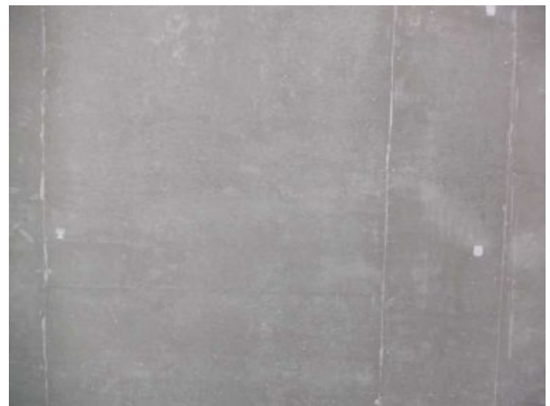
S2 바닥판 균열( C_w=0.2/L=1.6m )
