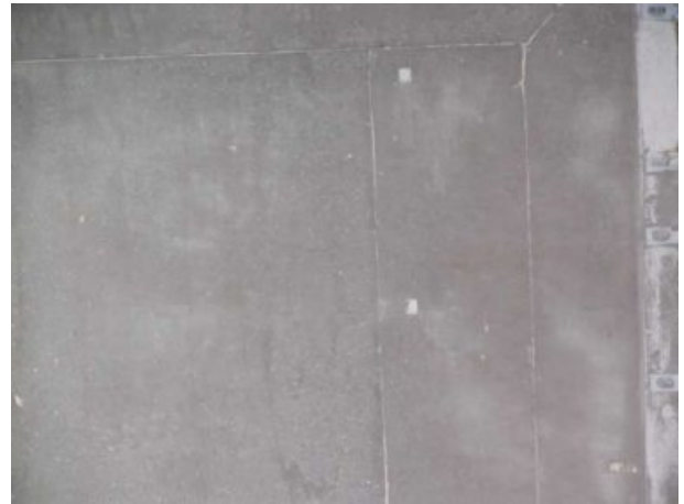
S2 바닥판 균열( C_w=0.2/L=1.0m )
