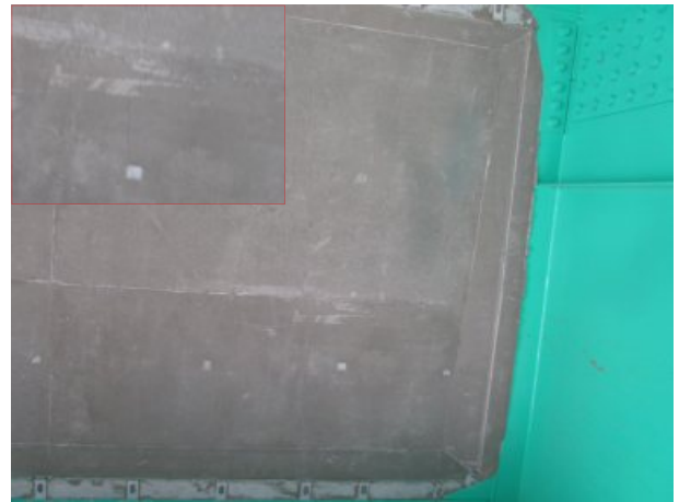
S4 바닥판 균열( C_w=0.3/L=1.6m )
