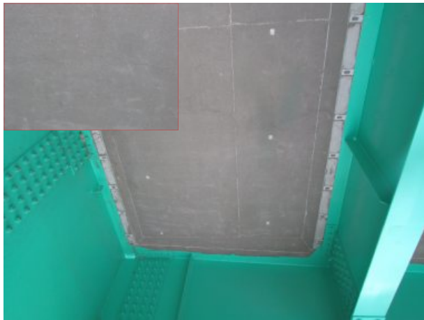
S3 바닥판 균열( C_w=0.2/L=1.6m )
